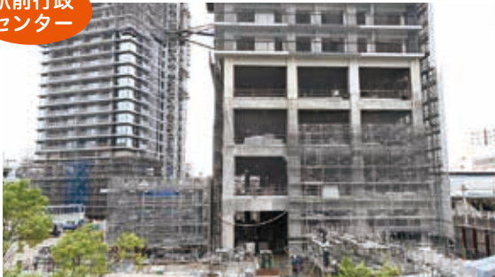
着実に建設工事が進む蕨駅西口再開発事業（先月9日撮影）
