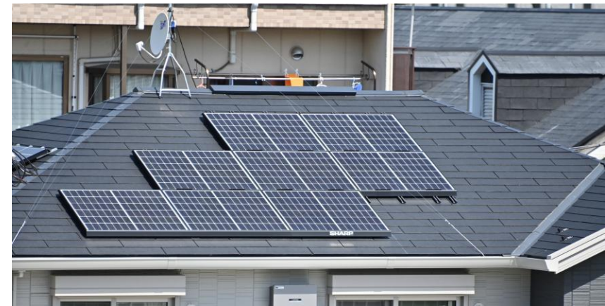
太陽光発電 システム
