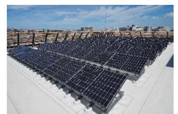
市庁舎屋上の太陽光発電設備
