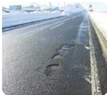
路面の穴ぼこ・ 段差
