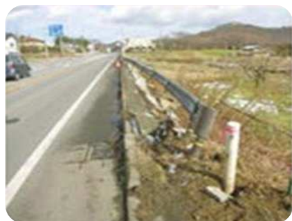
ガードレール・ 標識等の損傷
