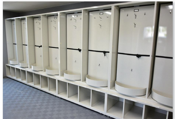
▲防火衣装着室
