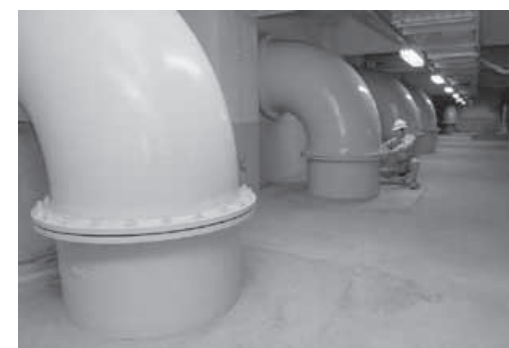
直径約1メートルの4本の管で雨水を放流（南町ポンプ場）
