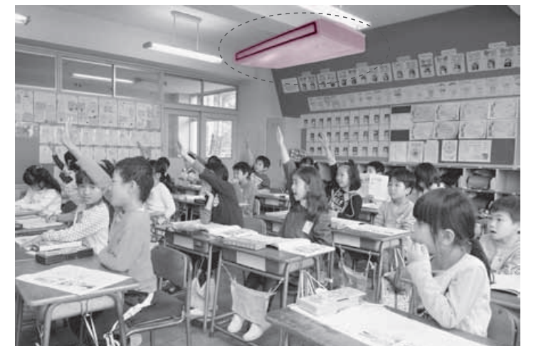
天井つり型のエアコンを全小学校に設置（写真は南小学校）
