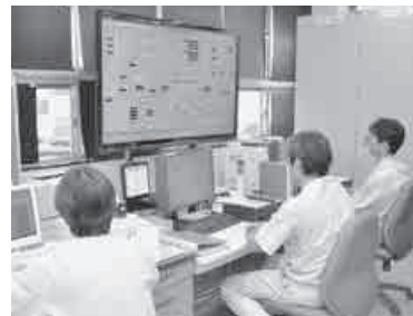
監視制御設備を更新した中央浄水場
