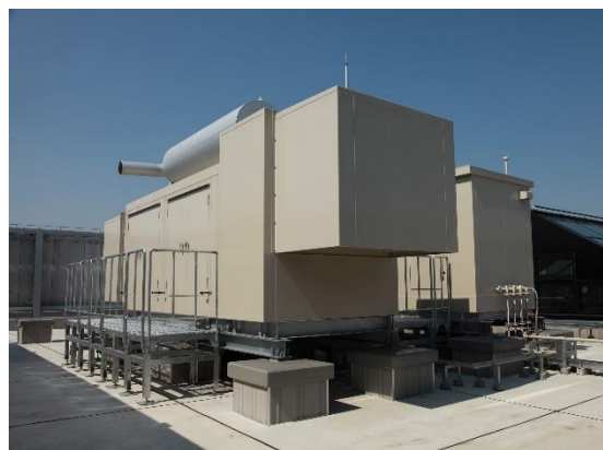
[自家発電システム]
